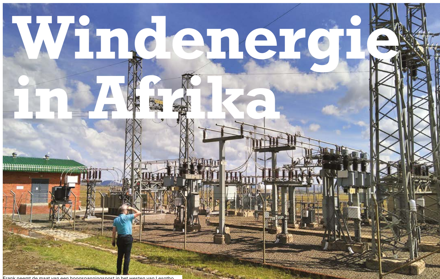
Frank neemt de maat van een hoogspanningspost in het westen van Lesotho.
